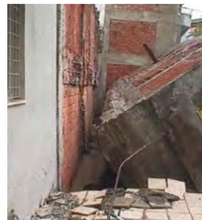
Problemas má execução de fundações
