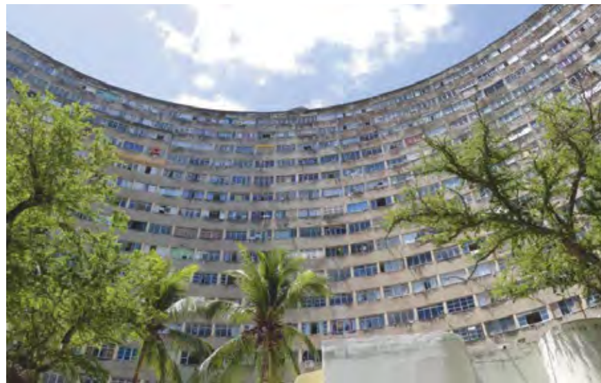
Falta de manutenção: tintas de má qualidade - não proteção da edificação
