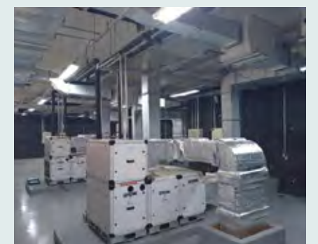
Sala de máquinas de ar-condicionado do centro cirúrgico.
