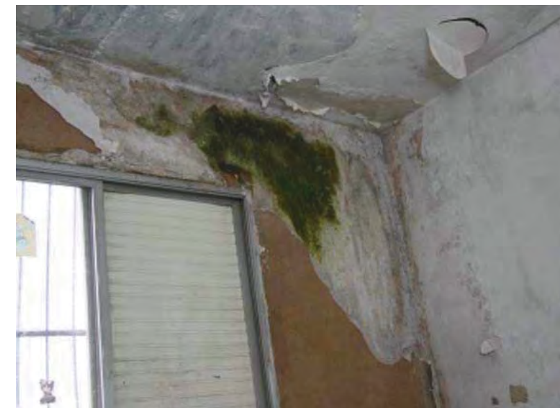
Problemas de impermeabilização
