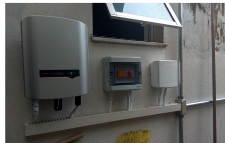
Nesta foto existem vários erros de instalação visíveis, como a utilização de materiais inadequados, sendo quadro de distribuição CA à direita sem vedação correta para instalação em área aberta externa, canaleta plástica com aberturas também inadequadas para área externa, cabos de corrente alternada passando junto com cabos de corrente contínua no mesmo duto.
