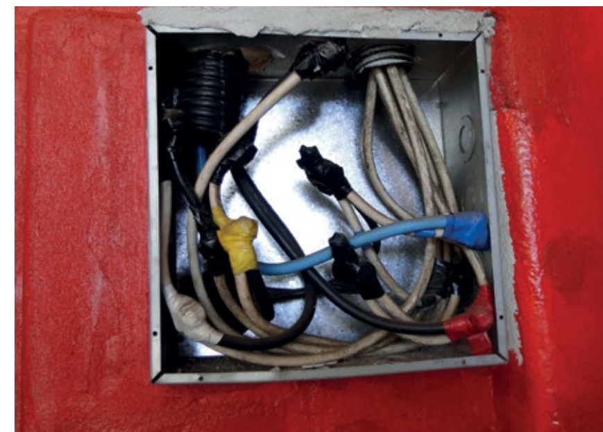
Caixa de passagem, na qual foi feita a derivação dos condutores para alimentação do sistema de geração de forma irregular, utilizando-se de conectores inapropriados e com isolamento deficiente, além da falta de aterramento, colocando em risco toda instalação. Neste caso, deveria ter sido projetado um QDG, com barramentos e disjuntores de proteção.
