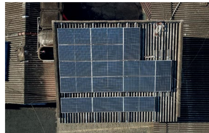
Telhado com avarias e visivelmente inadequado para a instalação de placas solares.
