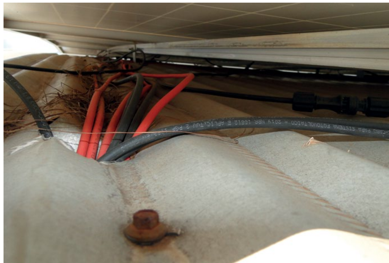
Aqui vemos um exemplo de instalação sem nenhum cuidado com os condutores, na qual fizeram um rasgo na telha metálica e passaram os cabos sem nenhuma proteção, deixando a isolamento dos cabos de corrente contínua em contato com as partes metálicas cortantes. Total irresponsabilidade, pois nesses condutores passam altas correntes em tensão CC.
