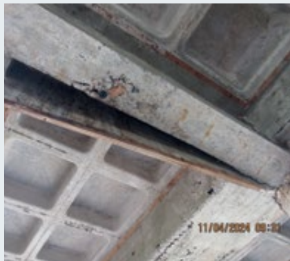
a) Materiais estranhos na viga
