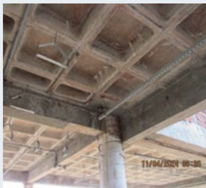
a) Eflorescência na face inferior da laje
