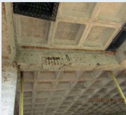
b) Corrosão de armadura na viga
